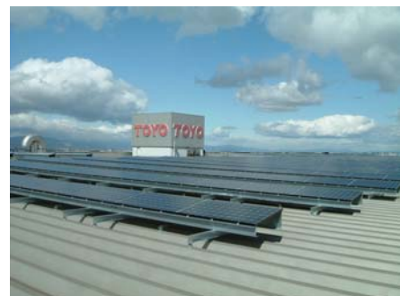
(金城ふ頭倉庫の設置状況)
