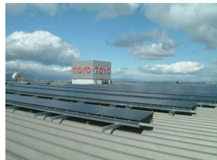
（金城ふ頭倉庫の設置状況）
